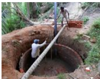
エコガス生産施設
